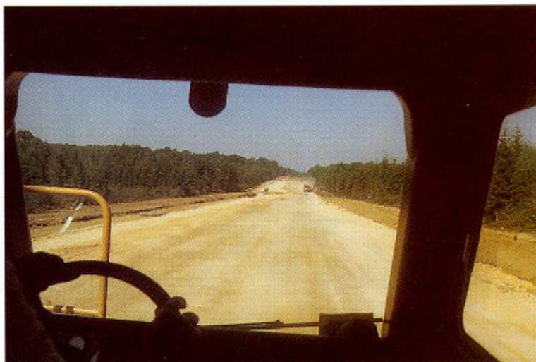
Une des fonctions "à court terme" primordiales de la couche de forme : assurer la circulation dans les meilleures conditions des engins approvisionnant les matériaux de la couche de fondation.
