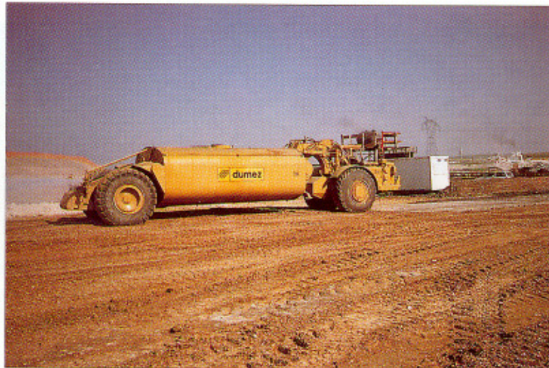
L'humidification des sols trop secs nécessite d'approvisionner de grandes quantités d'eau (souvent plus de 100 litres d'eau par mètre cube de sol) comme le montrent les imposantes dimensions de l'arroseuse représentée sur la photo (100m 3 )
